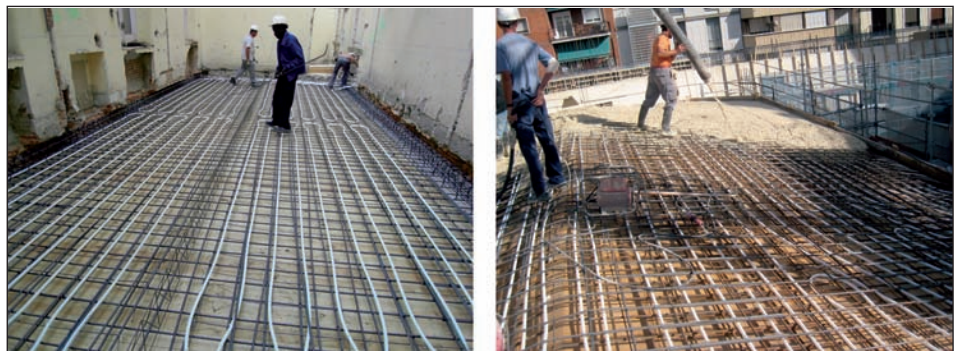
[Foto 8].- Vistas de la ejecución de las losas termoactivadas que resuelven la refrigeración y calefacción del edificio.
