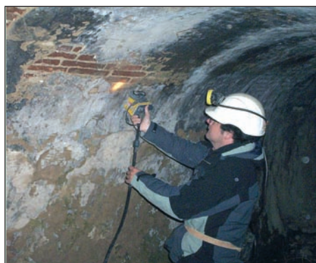
[Figura 9].- Perfil de georradar con antena de 2 GHz en el hastial de la mina del Puerto de la Cruz Verde.
