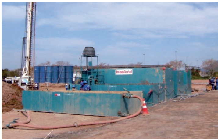
[Figura 4].- Planta de lodo polimérico de 3ª generación y al fondo los silos de almacenamiento del polímero acrílico.
