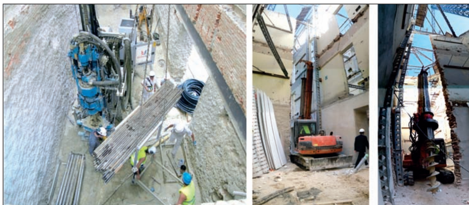
[Foto 5].- Proceso de ejecución de los intercambiadores verticales y los pilotes termoactivos del sistema Climapark en los espacios ajustados del edificio protegido en rehabilitación.
