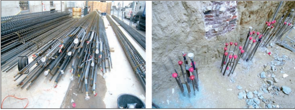
[Foto 6].- Vistas de las cajas de armado termoactivadas para los pilotes del sistema Climapark, y pilotes termoactivos alternos ejecutados en la pantalla del aparcamiento robotizado.
