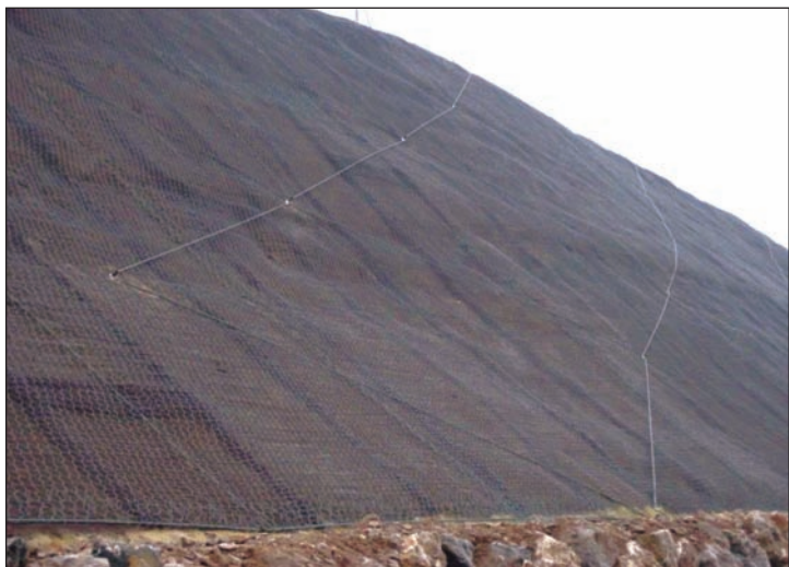
■ [Figura 10].- Vista detalle del talud tras el invierno.
